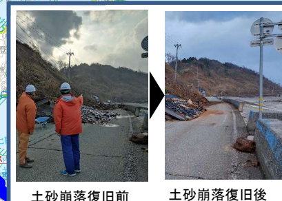
土砂崩落復旧前
